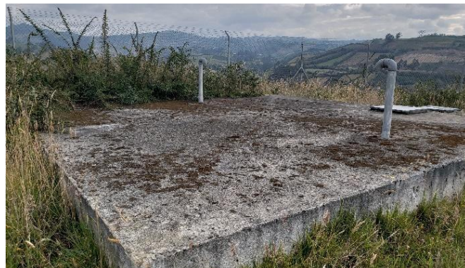
Figura 7-6 Tanque de Reserva – Jardines del Este
